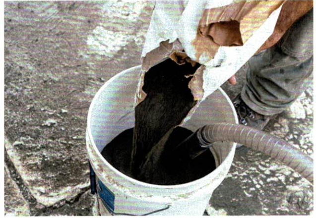
Für die gesamte Reinigung der Kirchenfassade kamen rund 200 Kilo des Strahlmittels aus Aluminiumsilikat zum Einsatz
